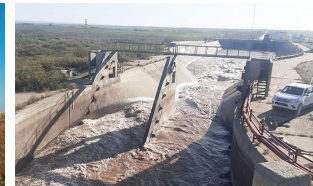
Central Hidroeléctrica Los Divisaderos, 25 de Mayo
